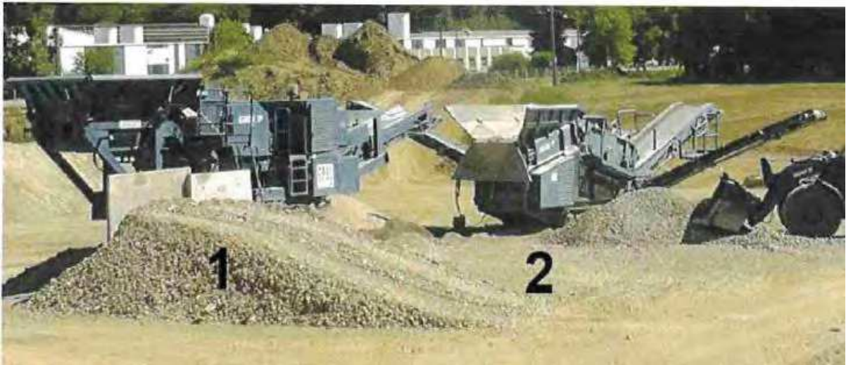
Exemple d'installation mobile de recyclage de matériaux inertes (photo prise sur un autre site). 1 : groupe mobile de concassage ; 2 : groupe mobile de criblage
